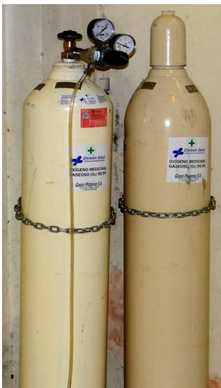
Fig. 6: Tanque de oxígeno médico y válvula reductora.
